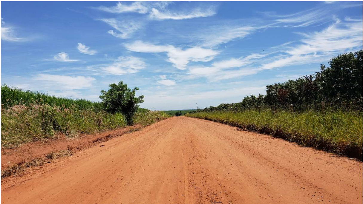
Figura 48 – Estrada larga mais sem saída d'água.
