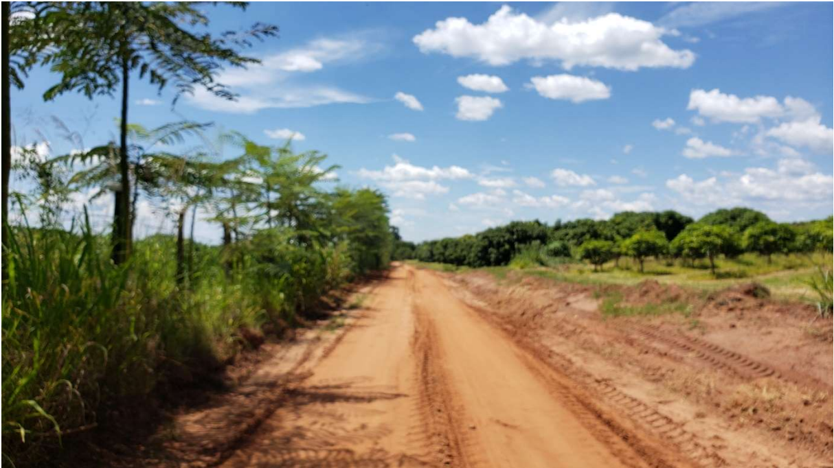
Figura 46 – Trecho sem saída d'água.
