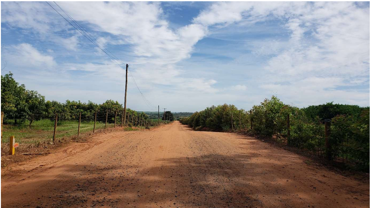
Figura 38 – Estrada em conformidade.
