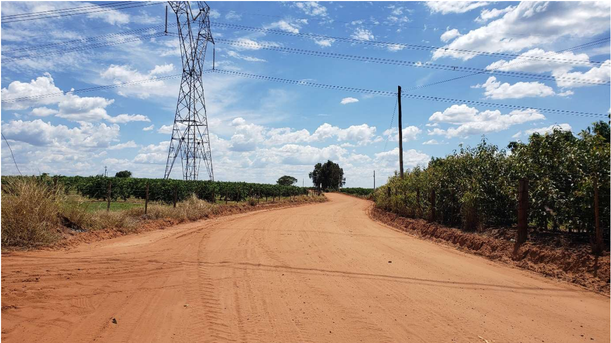
Figura 47 – Longo trecho sem revestimento.
