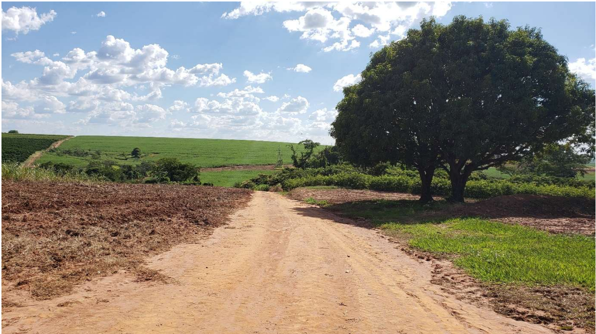
Figura 63 – Plataforma não conformada.
